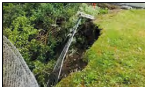
Avant travaux - effondrement de la canalisation
